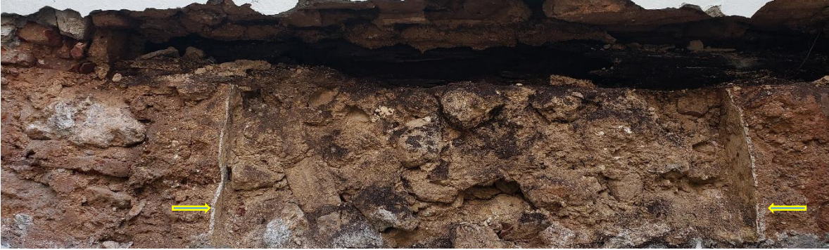
Detalles del nicho u hornacina liberado en el muro medianero este en la segunda crujía. Las flechas amarillas favorecen la identificación de las jambas encaladas de este elemento.
