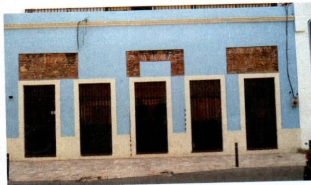
Arz. Meriño # 309 desproporcionadas alturas de dinteles originales
