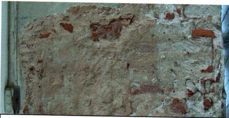
Paramentos originales conservados en el testero, y que han sido cubiertos por varias capas de revoques.
