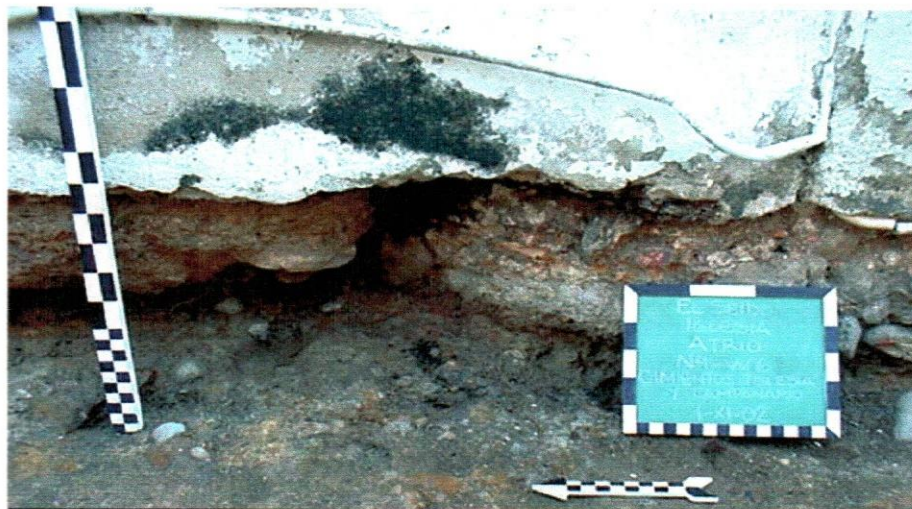
Adosamiento del cuerpo del campanario a la fachada de la iglesia, notándose la diferencia de nivel entre los dos componentes.
