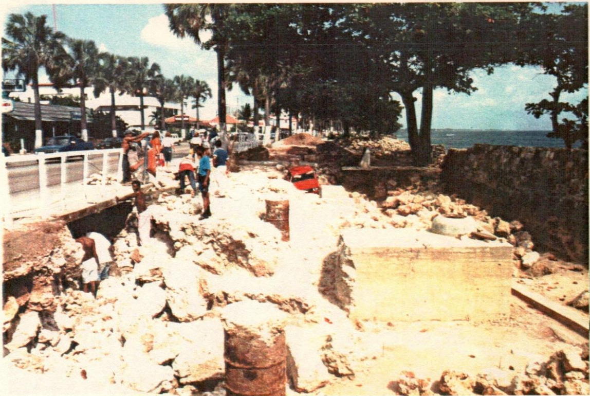
25- Registro sanitario gigante, el cual debió ser demolido por ocupar el sitio de uno de los fortines.
