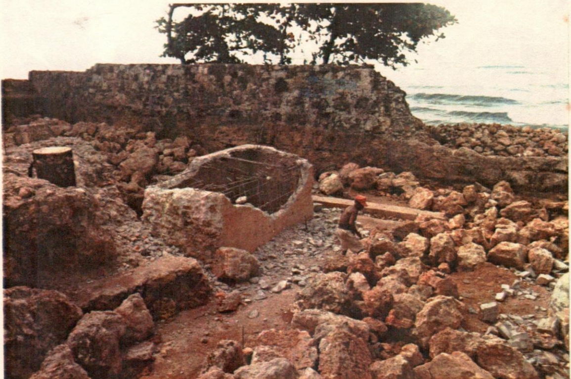
26- Registro gigante, en demolición. En la foto No.15 se puede ver como estaba al inicio de la obra y en las fotos No.18 y 23 se puede observar después de la excavación.
