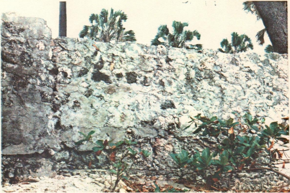
60- Vista del estado del muro exterior.
