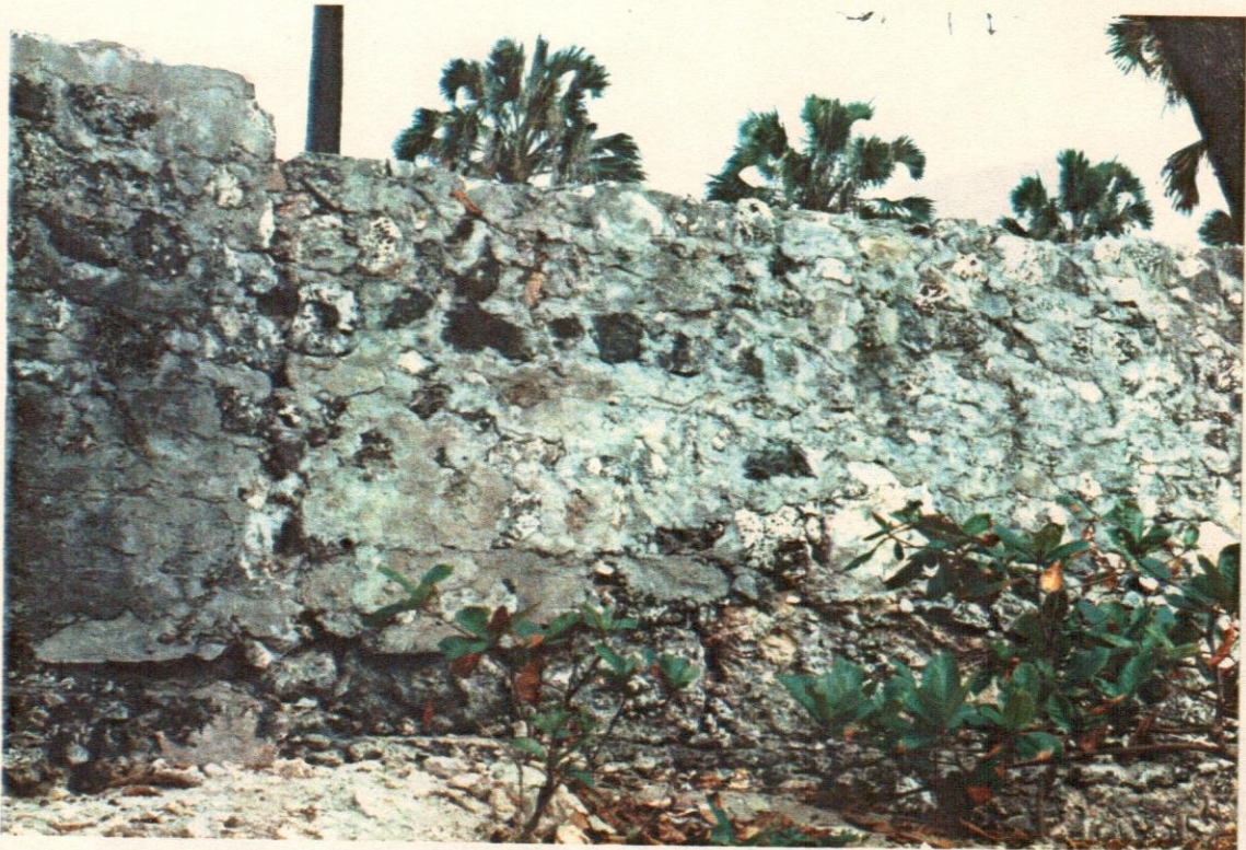
8- Vista del pañete de cemento del muro sur del foso.
