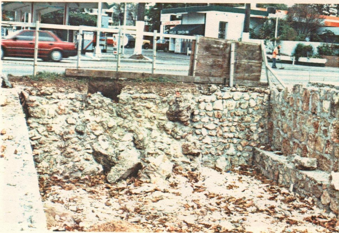
43- Encache de hormigón y piedra rústica en el area oeste del foso.
