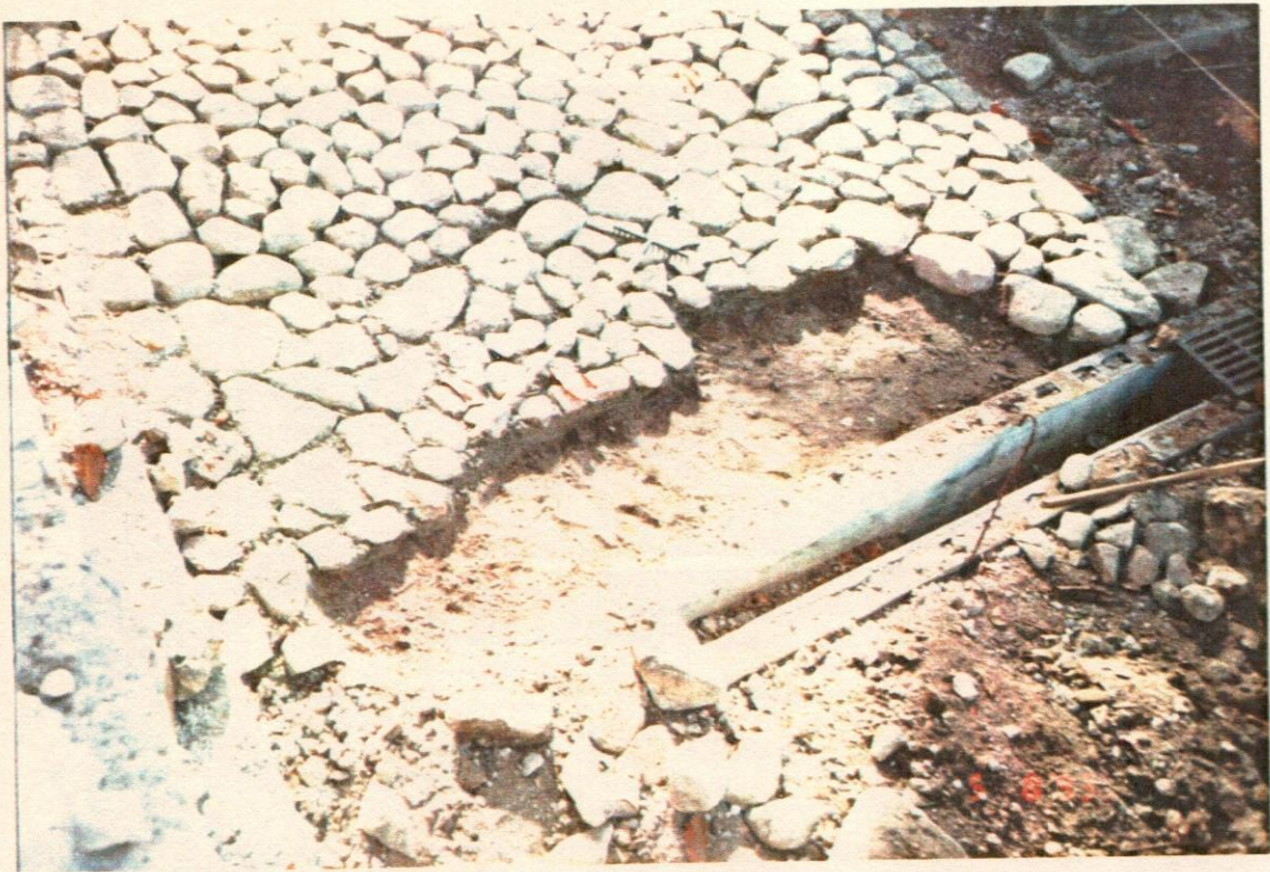
125- Colector de agua pluvial.
