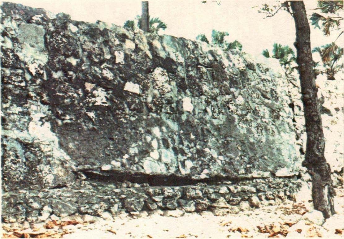
7- Vista del pañete de cemento del muro sur del Foso.
