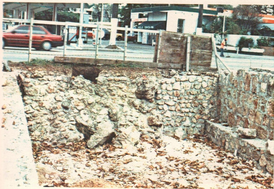
43- Encache de hormigón y piedra rústica en el area oeste del foso.
