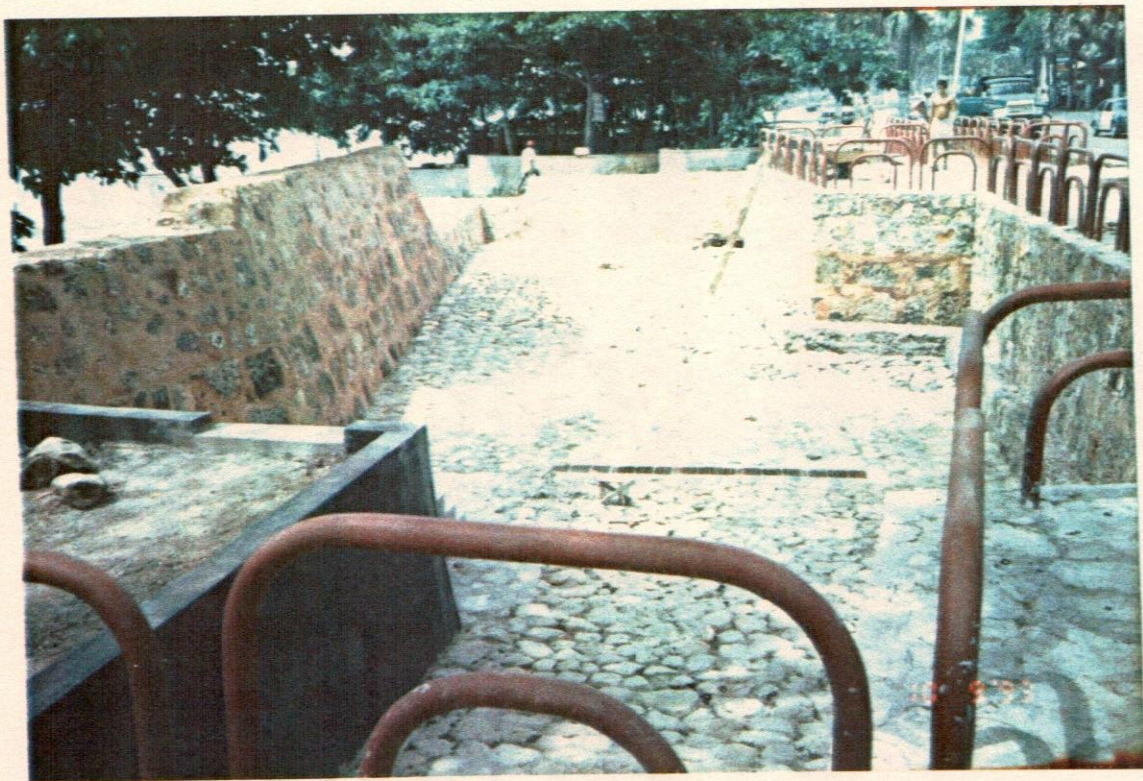
126- Colector de agua pluvial, al centro de la foto.
