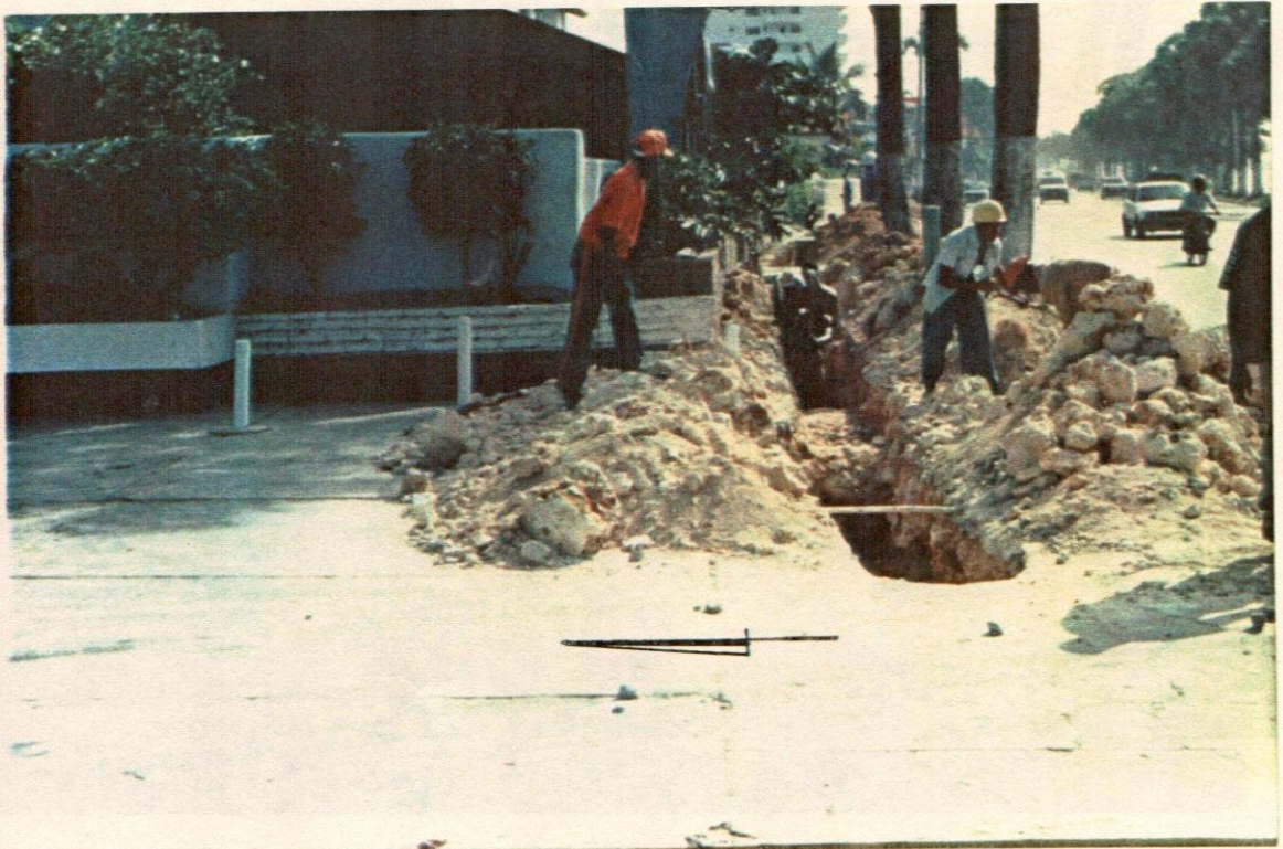
Foto 9-. Vista de excavaciones realizada por la CAASD, donde se localizó muro Este del Foso, el cual fue cortado para dar paso a la tubería del sistema de agua potable.
