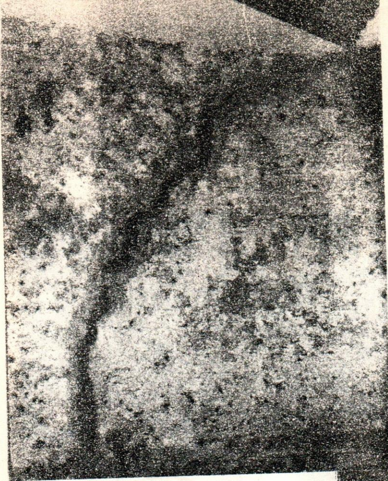
Agrietameinto en la pared norte.
